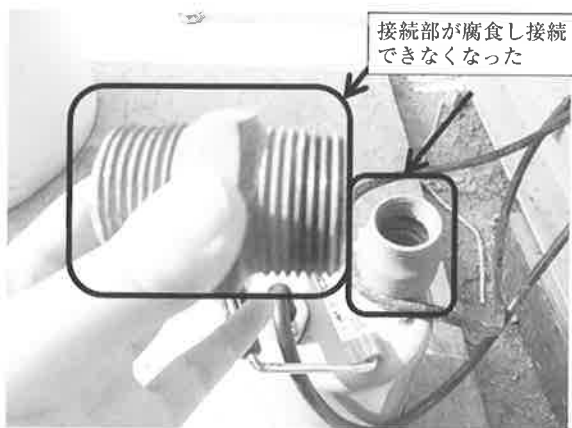
写真3 SPS水溶液600L程度の送液に使用したポンプ
